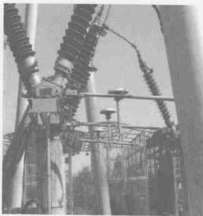
图 7-17 感应型高压带电显示验电装置的使用
