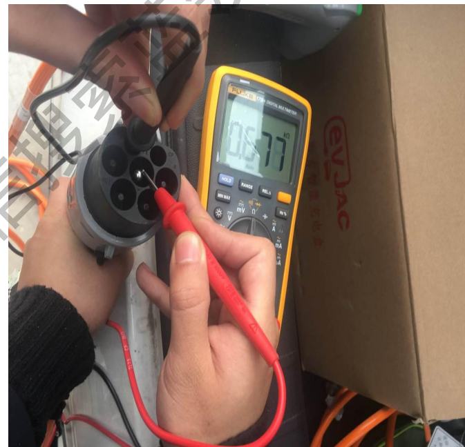
充电桩充电线缆测量CC信号 与PE阻值为680Ω
