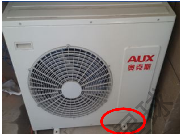
外机底脚未固定，运行时震动会使空调掉落
