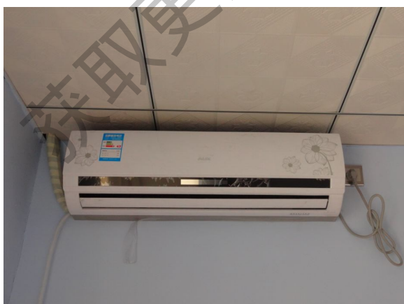
室内机安装不规范，没有足够的维修空间
