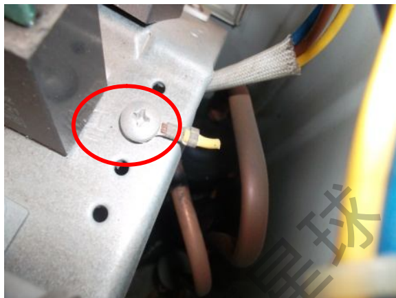
压机接地线剪断，未接地线
