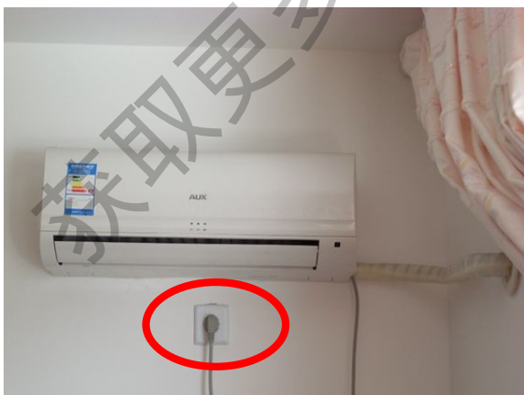
插座安装在空调正下方 内机漏水滴落在插座上导致短路
