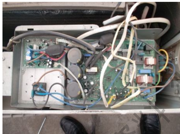
变频机电器盖板未盖
