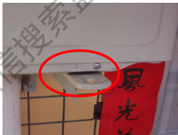
螺栓不够会导致外机固定力不足 易导致外机掉落等安全事故发生
