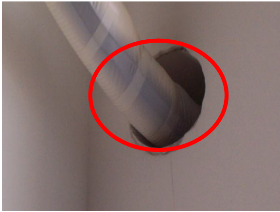
出管墙孔没有进行使用穿墙护圈且未用腻子密封
