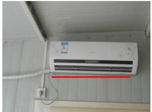
内机安装不水平，内机倾斜容易造成内机漏水
