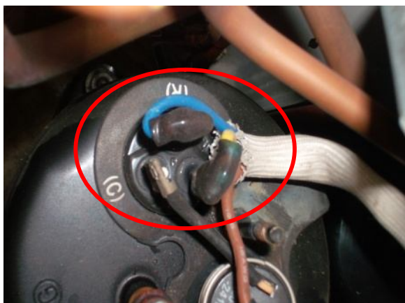
压缩机保护盖未装
