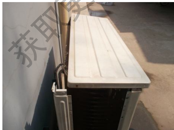
外机顶盖板安装不规范
