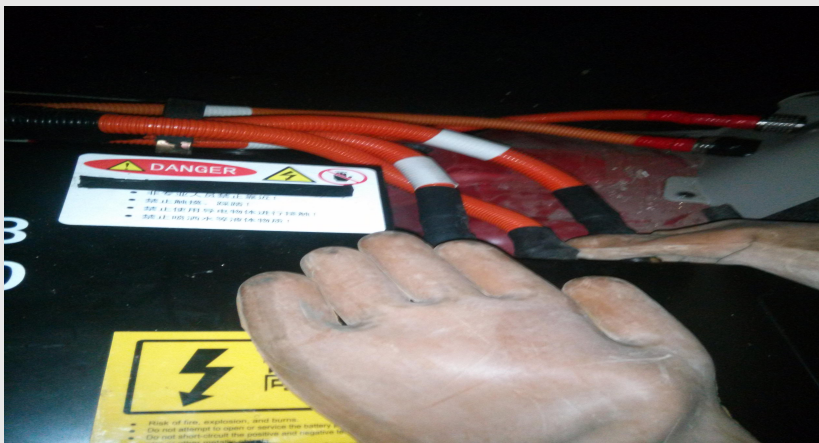
9 拆下说有高压电缆线
