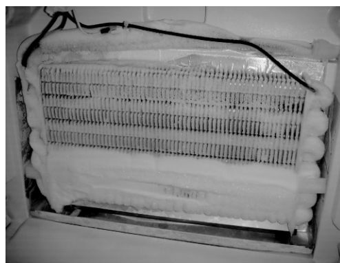
图9 改进前蒸发器结霜情况
