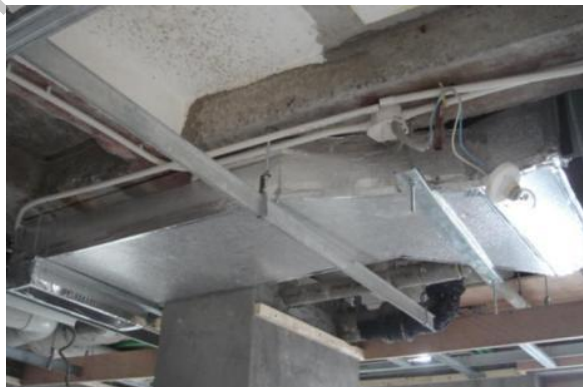
FDUT 连接风管，不能确保送风量
