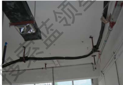
冷媒管固定支架间距过远
