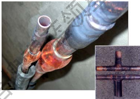
冷媒铜管没有充氮焊接，产生氧化膜，造成系统脏堵
