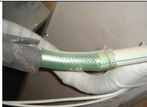
不规范的连接，极易导致漏水，如将豪华天花板损坏，损失将非常巨大
