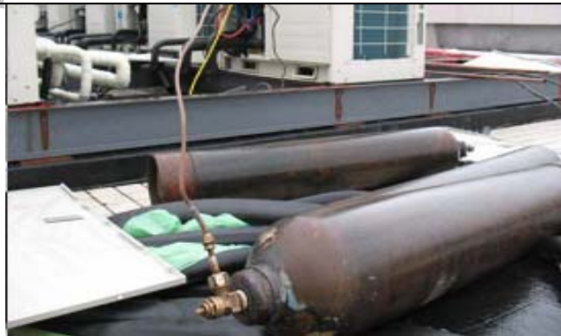
保压没有使用减压阀操作危险，并易引起管路爆裂
