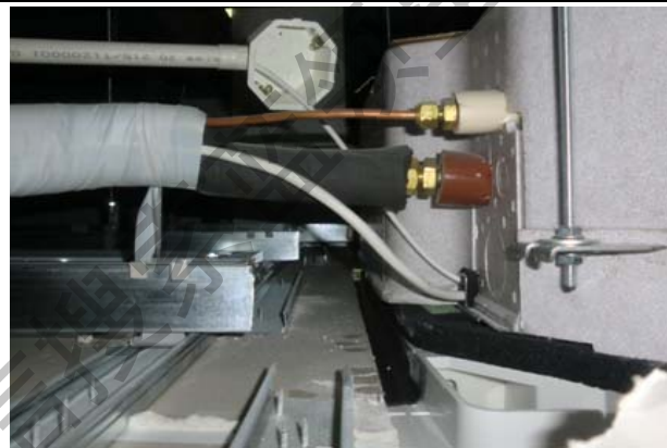
没有使用机器附带的保温进行包扎，易产生凝露漏水
