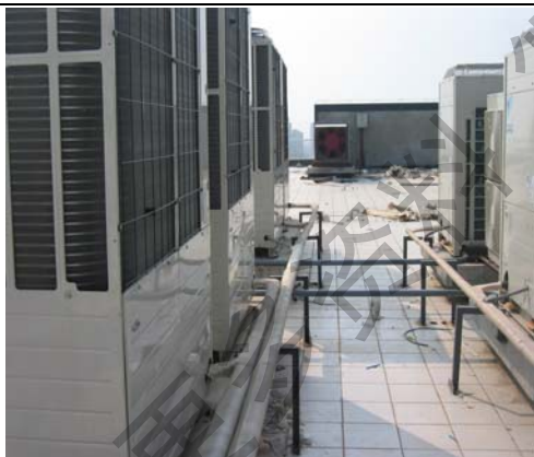
室外机的冷媒管同样需要固定
