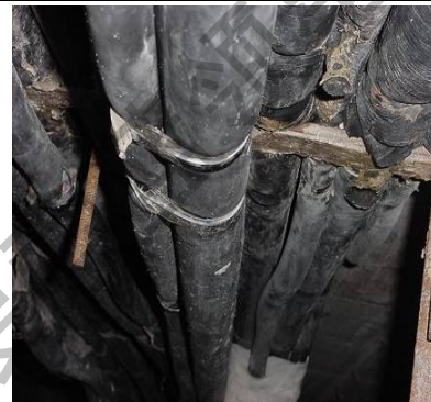
竖直管道固定不规范，易产生冷桥
