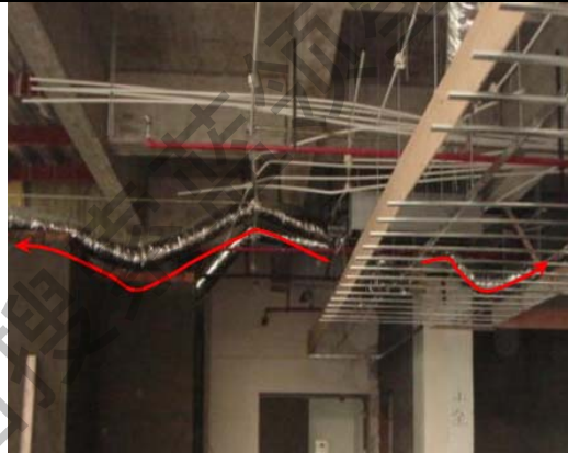
使用软管没有采取固定措施，软管易凹陷
