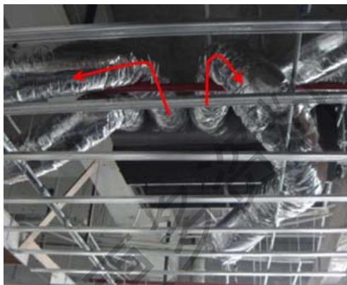
软接急剧转弯，阻力不均匀，送风不均匀
