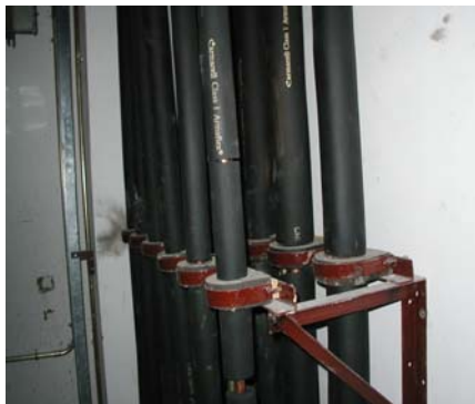
竖直管道固定规范合理
