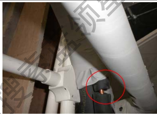
保温断面没用胶水及胶带连接，接口处易张开凝露
