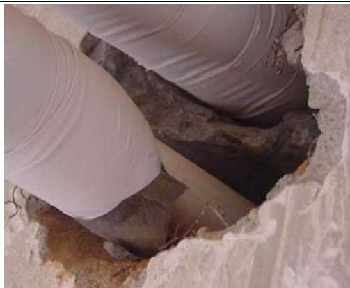
铜管穿墙没有使用套管保护，容易破坏保温产生凝露
