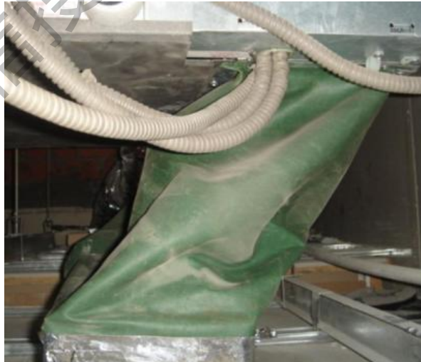
回风风道软接过长，易产生扁塌，产生噪音等
