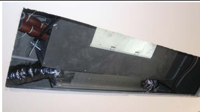
FDUT 采用送风软管，风量急速衰减，严重影响效果
