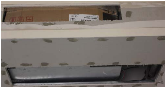
回风口兼检修口，
