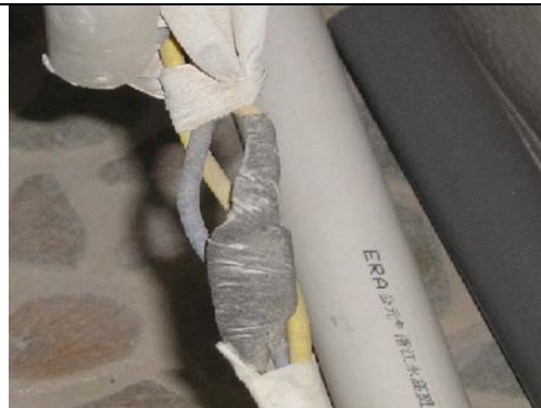
电源线中间接驳，没有使用套管，容易产生松脱及漏 电的现象，非常不安全
