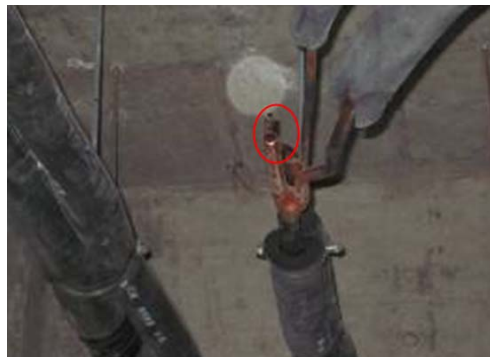
冷媒铜管施工时封口不及时，脏物易进入管道
