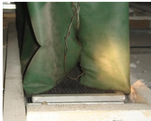
回风口软接没有固定好，导致外部未过滤的风进入
