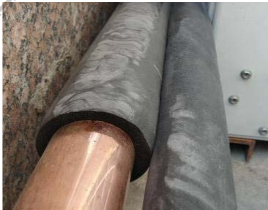
保温厚度不符合要求，表面会产生凝露漏水
