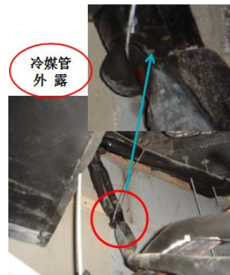
局部管道固定不规范，导致铜管外露，使用时会漏水
