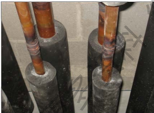
保温棉与铜管匹配，气液管分开保温
