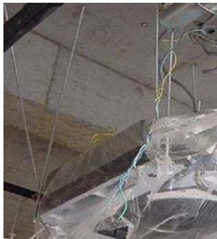
吊杆高于 1.5m 时应采取加固措施
