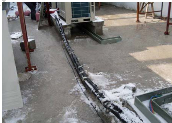
室外机没有固定，随意放置
