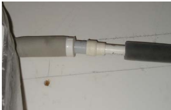
排水管连接处没有保温，易产生凝露漏水
