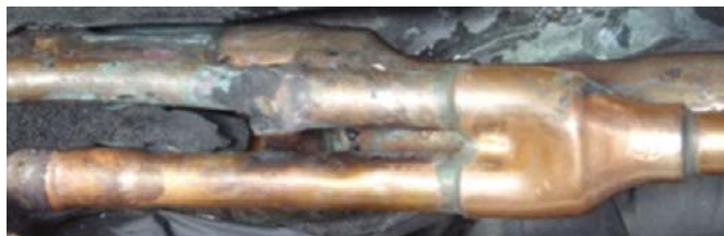
市场杂牌分支管（厚度不够，易爆裂）
