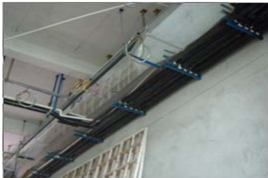
冷媒管固定支架间距合理
