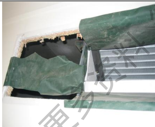
送风口软接没有固定好，导致漏风
