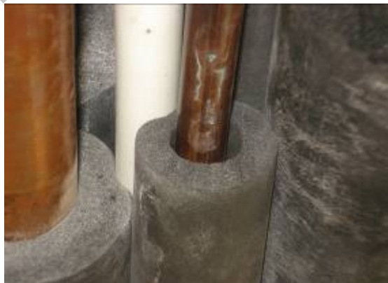
保温棉与铜管不匹配，易凝露漏水
