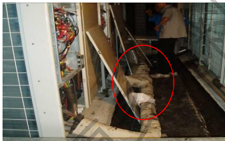
分歧管安装不水平，造成冷媒分流不均（错误）
