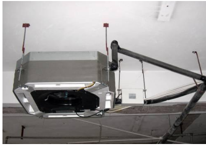
室内机吊装好后没有做防尘处理 排水管提升处没有固定（差）
