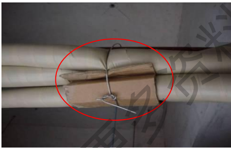
冷媒配管没有很好的固定，采用铁丝捆绑。（错误）
