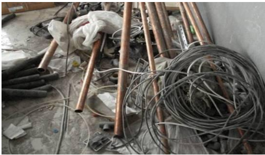
材料堆放零乱（差）
