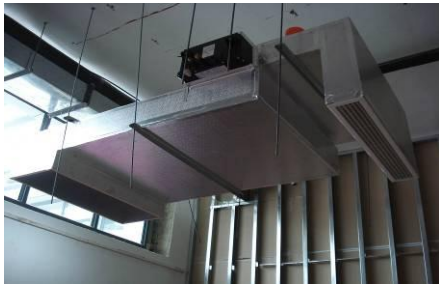
T3 室内机风管安装不合理，导致 制冷、制热效果差（错误）
