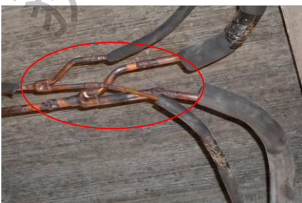
前后距离不到 0.5m 急转弯。分歧管 管垂直安装，导致冷媒分配不均匀， 影响效果（错误）
