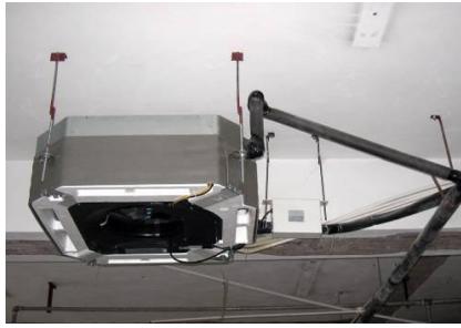
室内机吊装好后没有做防尘处理 排水管路提升处没有固定（差）
