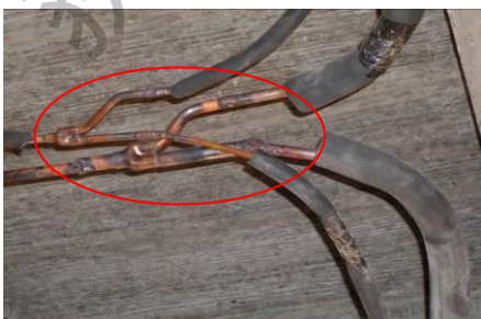
前后距离不到 0.5m 急转弯。分歧管垂直安装，导致冷媒分配不均匀，影响效果（错误）
