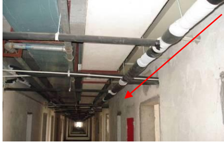
冷凝排水管路上没有设置通气口，影响排水（错误）
