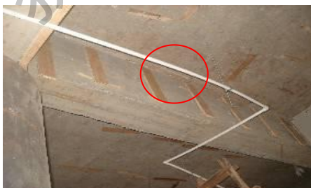
排水管路吊杆间距太宽，且冷凝水管 没有做保温（错误）
