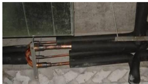
分歧管安装水平，分歧管前后直管段距离符合要求（前后直管段距离 0.5m）（正确）
