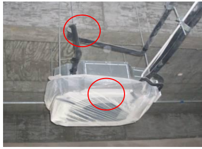
室内机完成吊装后做了有效的防尘处理， 排水管路提升后做有效的固定（好）
