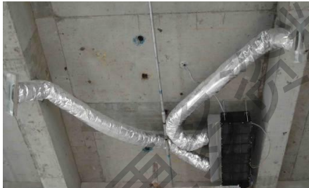
室内机采用软风管，软管拐弯太急 （错误）（要保证送回风顺畅）
