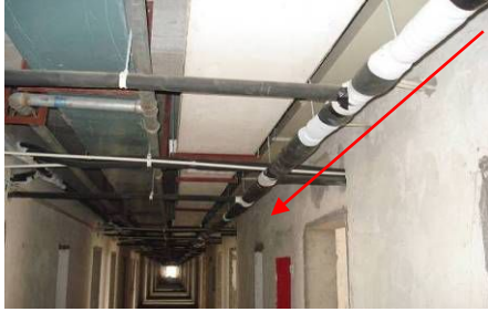
冷凝水管路上没有设置通气口，影响排水（错误）
