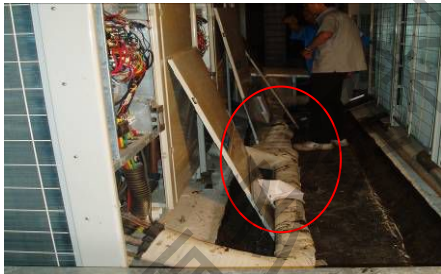
分歧管安装不水平，造成冷媒分流不均（错误）
