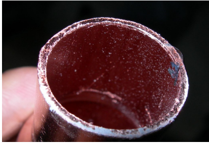
铜管使用钢锯切割，导致管内有大量铜屑，管口不平整（错误）
