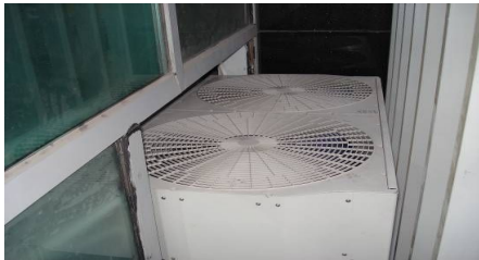
外机安装在狭小的空间，散热效果差维修不方便（错误）
