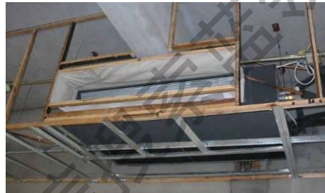
T3 风管机安装时候不接管，采用下回 风，侧送风的气流组织形式（正确）
