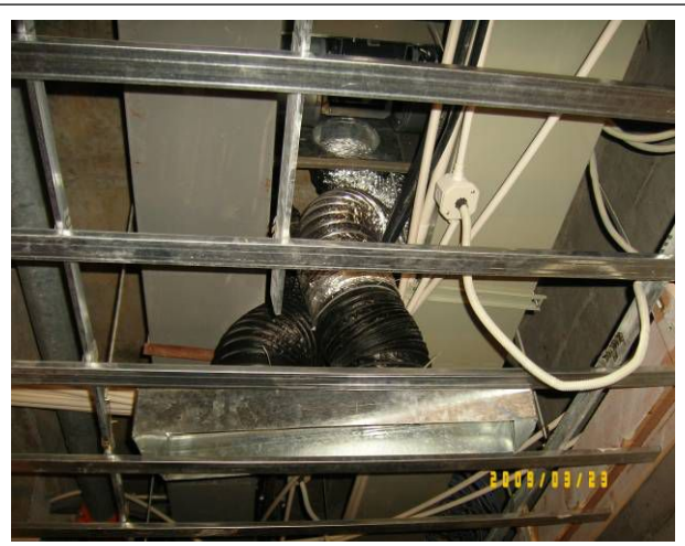
回风口采用软管引接，且软管不直，不利于回风，导致回风量不够，房间循环风量小。
