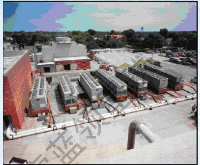
为一所大学提供 2400 冷吨的冷量
