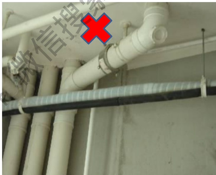
水管与冷媒管不能集中固定，应独立分开
