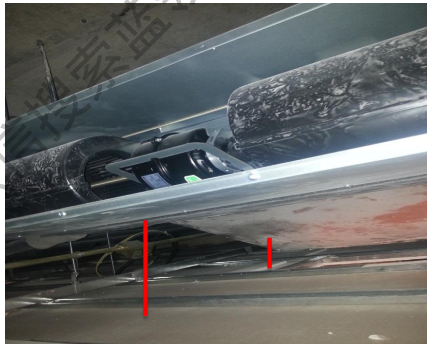
出风风道未进行固定，导致风道脱落。
