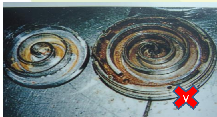
异物进入后，压缩机损坏
