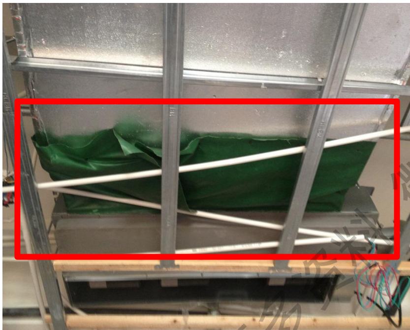
室内机与风道之间密封处理不良
