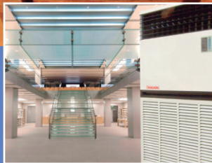
安装于报告厅
