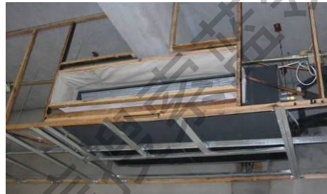
T3 风管机安装时候不接风管，采用下回 风，侧送风的气流组织形式（正确）
