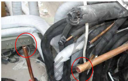
铜管裸露在外面，没有封口。导致水、灰尘、杂物进入管内。影响设备正常运行（差）
