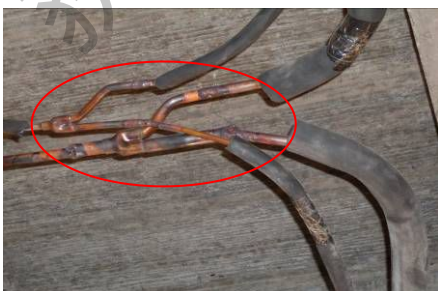
前后距离不到 0.5m 急转弯。分歧管 管垂直安装，导致冷媒分配不均匀， 影响效果（错误）
