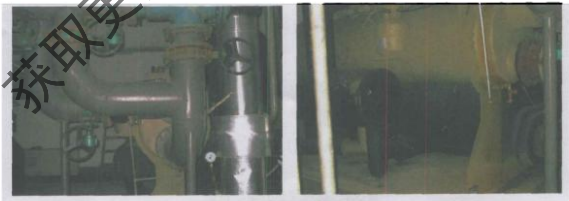
图 3.3 商场空调系统主机设备图
