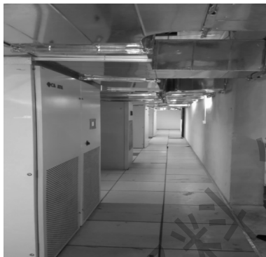
图 2 改造前该数据中心的空调系统 Fig. 2 Air conditioning system before transformation
