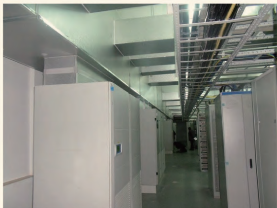
(a) 原机房空调室内机及主、支风管
