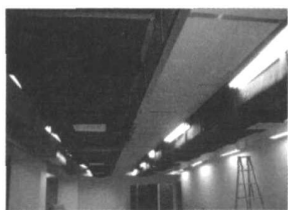
图3 经分机房冷通道布置全貌图
