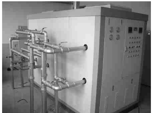
图 1 高温热泵系统
