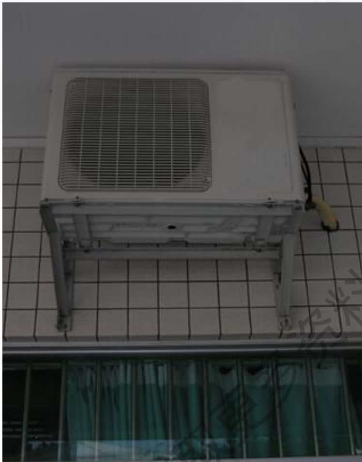
外机紧贴屋顶，不便操作
