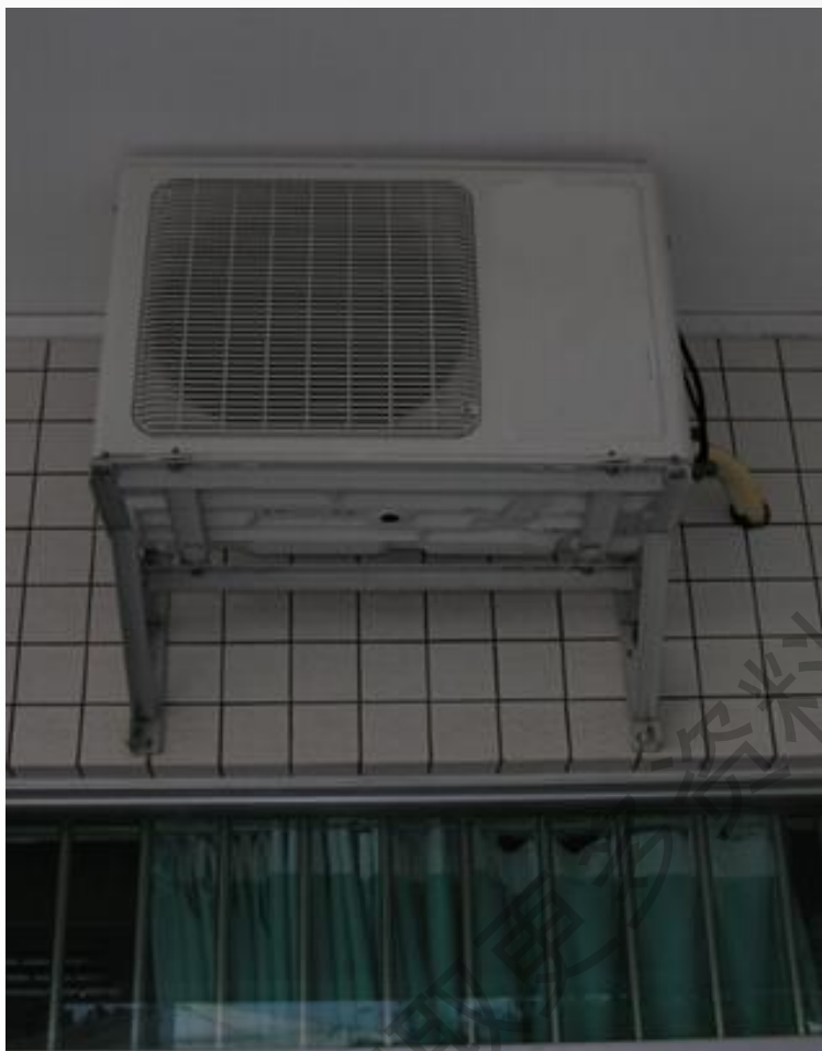
外机紧贴屋顶，不便操作
