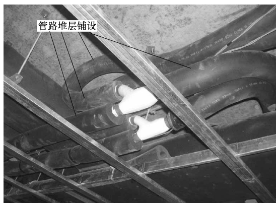
图 3-71 分岐管安装时管路堆层铺设错误示意图
