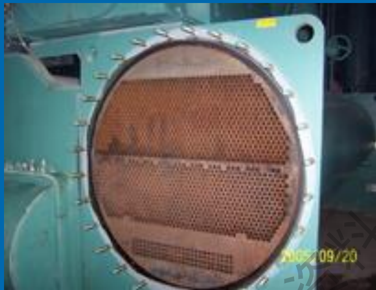
空调制冷机组
