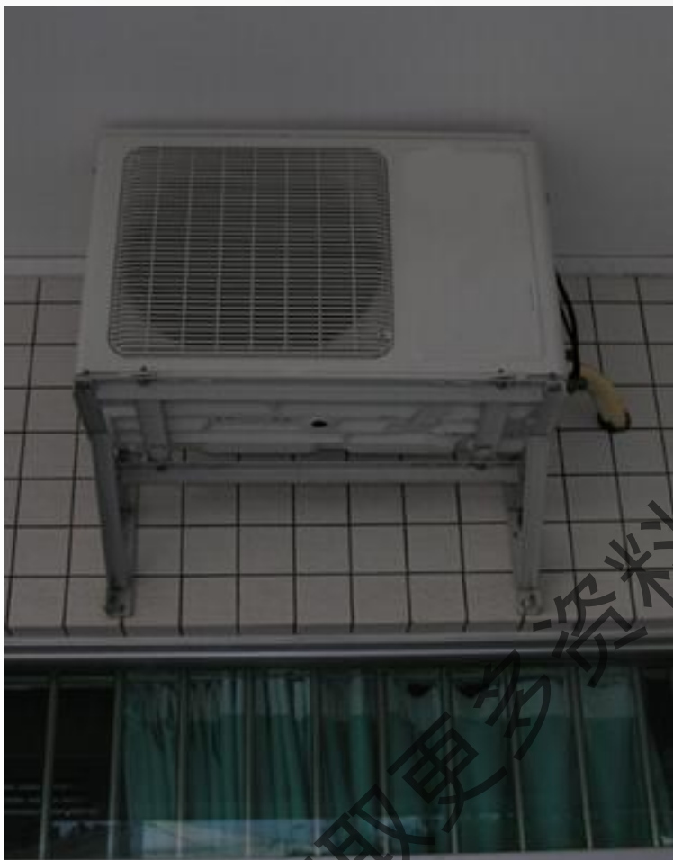
外机紧贴屋顶，不便操作
