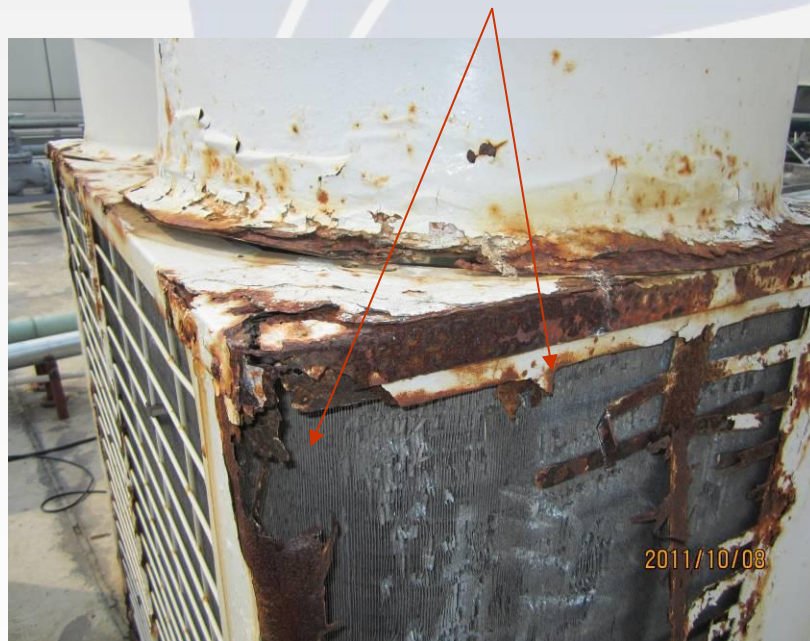
机组一侧严重腐蚀
