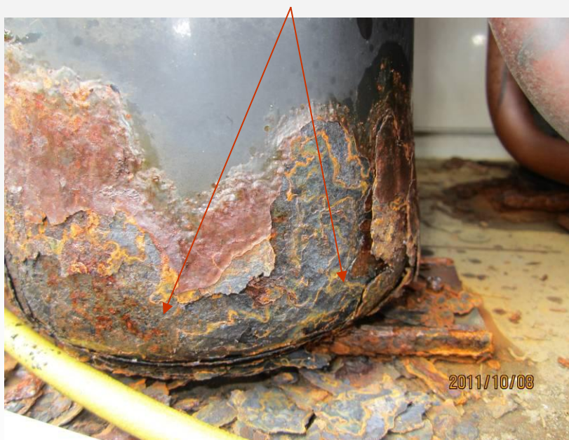
底部严重腐蚀
