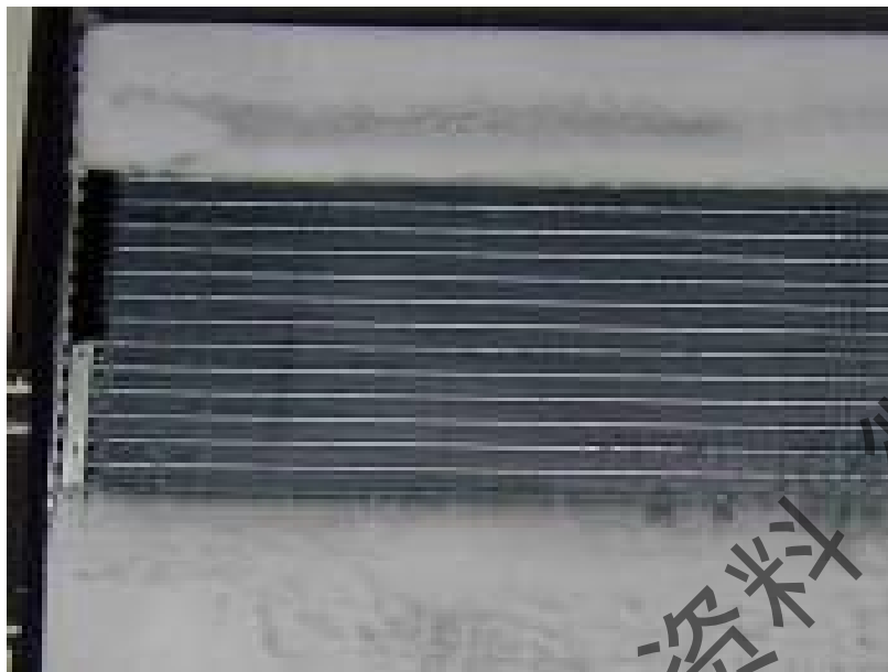
蒸发器表面结霜严重不均
