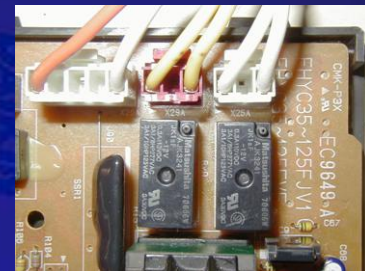
排水泵，室内机风扇继电器
