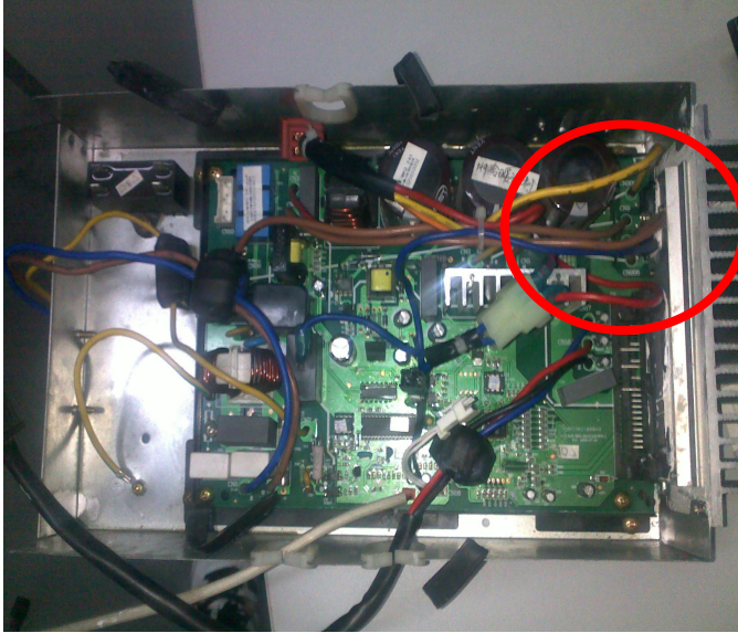
无源PFC方案室外电控盒全景图
