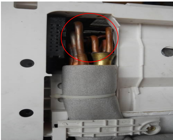
图 1.保温管仅包住分配器一部分
