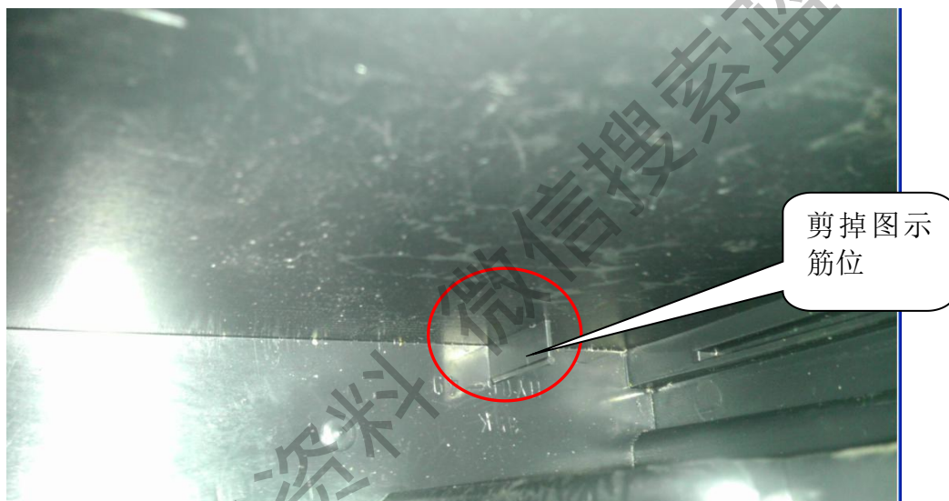
图二、电控盒内部
