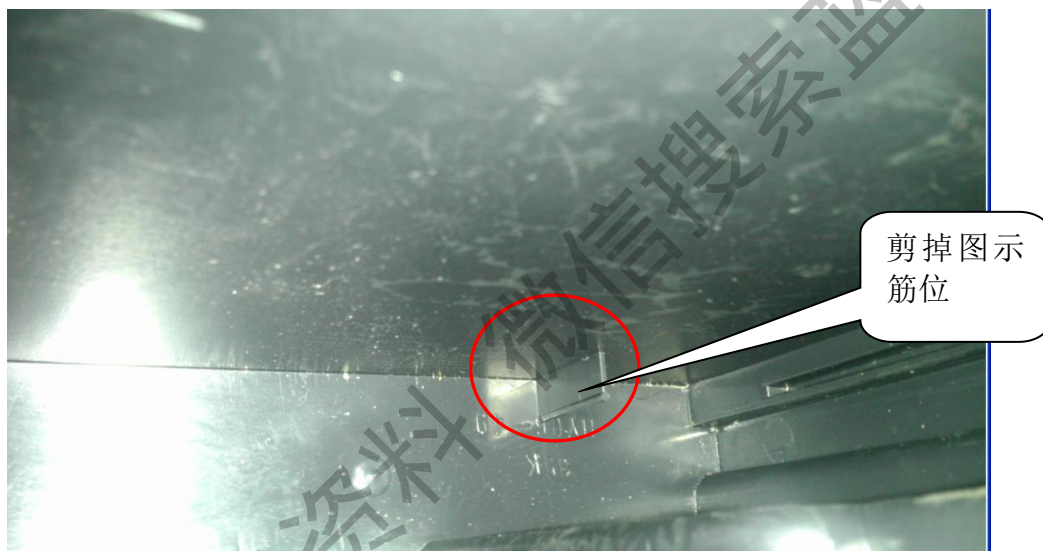
图二、电控盒内部
