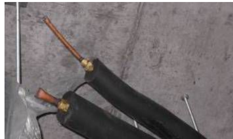
管路施工完成后要对管路进行封口处理，焊封或是用胶布封口（好）
