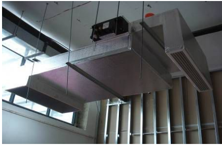
T3 室内机风管安装不合理，导致 制冷、制热效果差（错误）
