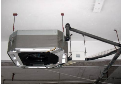
室内机吊装好后没有做防尘处理 排水管路提升处没有固定（差）
