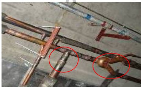
室内机分歧管使用 T、Y 型三通代替（错误）
