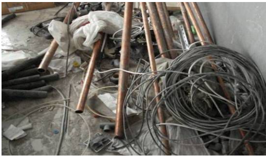
材料堆放零乱（差）
