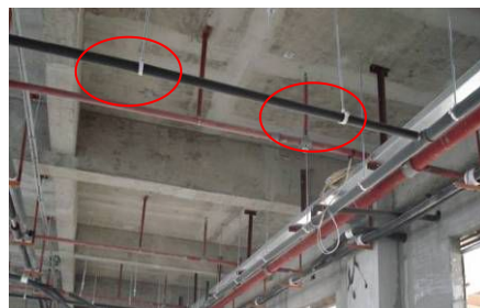
冷凝水管安装规范，吊码间距符合要求 吊杆间距 1m（正确）
