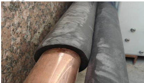
保温管厚度不够，保温效果差，管壁产生冷凝水（差）
