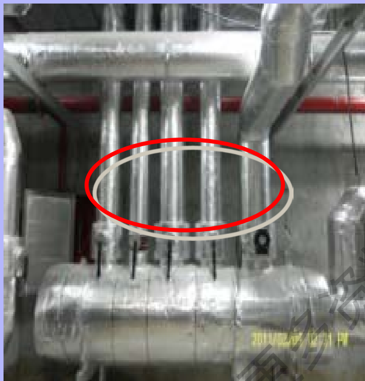
水管无标注水流方向，现场配合人员不清楚水的流向，
