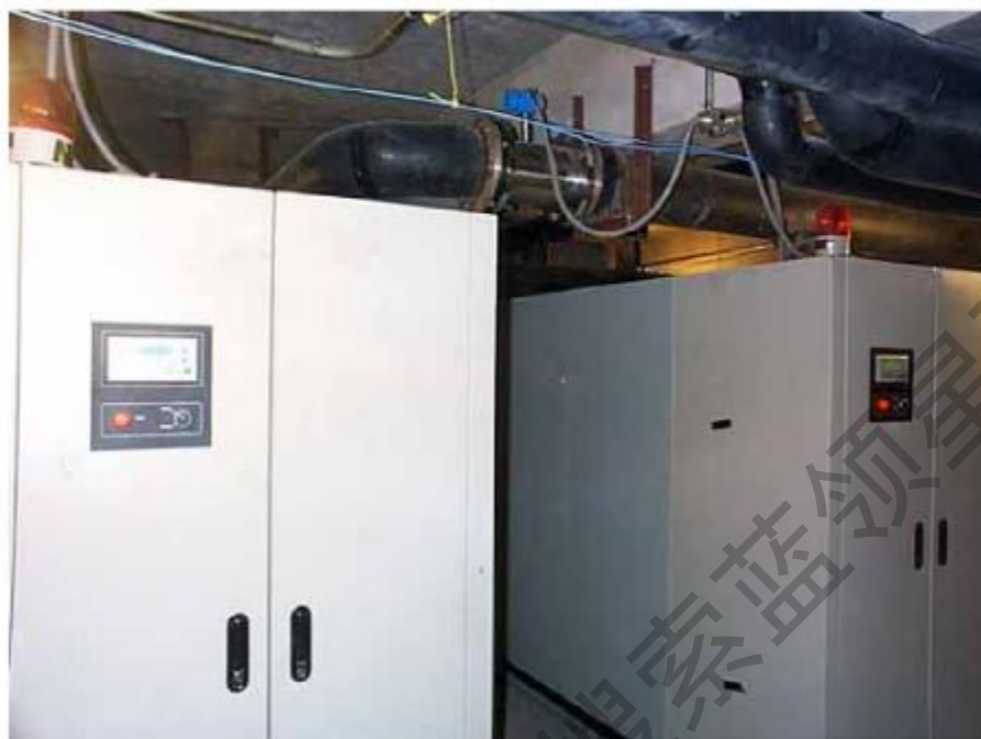
图 4-17 地源热泵实验系统地面机房系统
