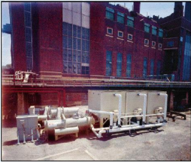
为一家工厂提供 8700 冷吨的冷量
