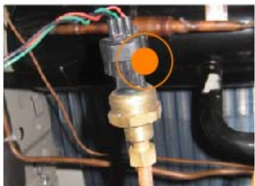
通过压力传感器时刻 检测系统压力
