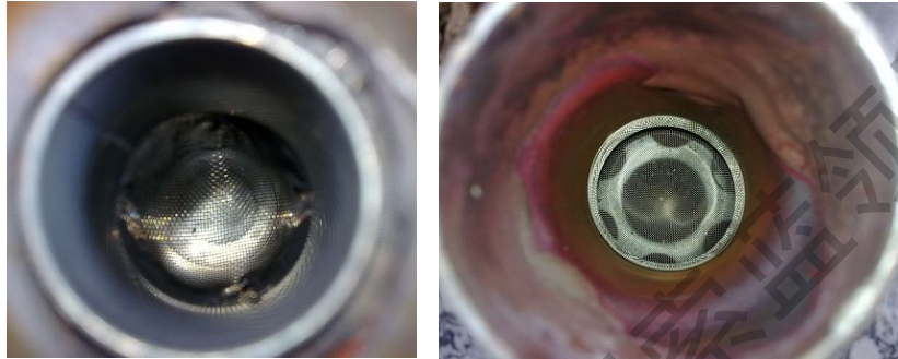
干净的压缩机回气管滤网
