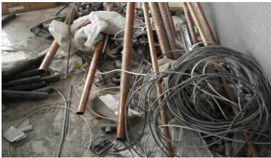
材料堆放零乱（差）
